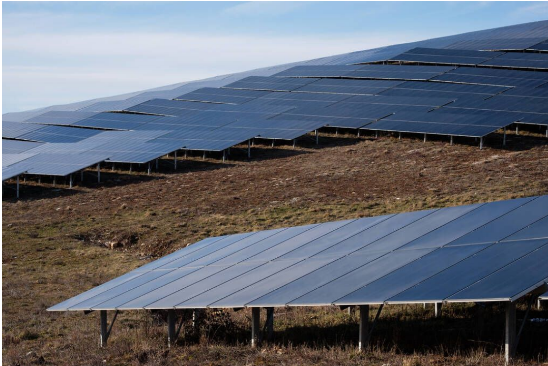
En 2023, centrale solaire photovoltaïque de La Tieule (Lozère) avec près de 35 000 panneaux photovoltaïques pour une puissance installée de 15 MWc (mégawatt-crête) sur 18 ha. (Antoine Berlioz/Hans Lucas. AFP)
